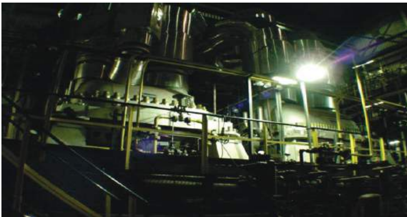
Compressore centrifugo gas siderurgici - CET3
