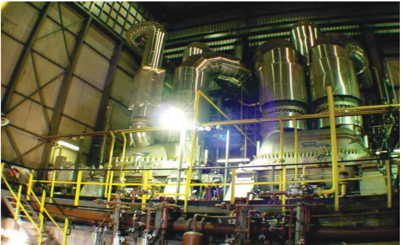
Compressore centrifugo gas siderurgici - CET3
